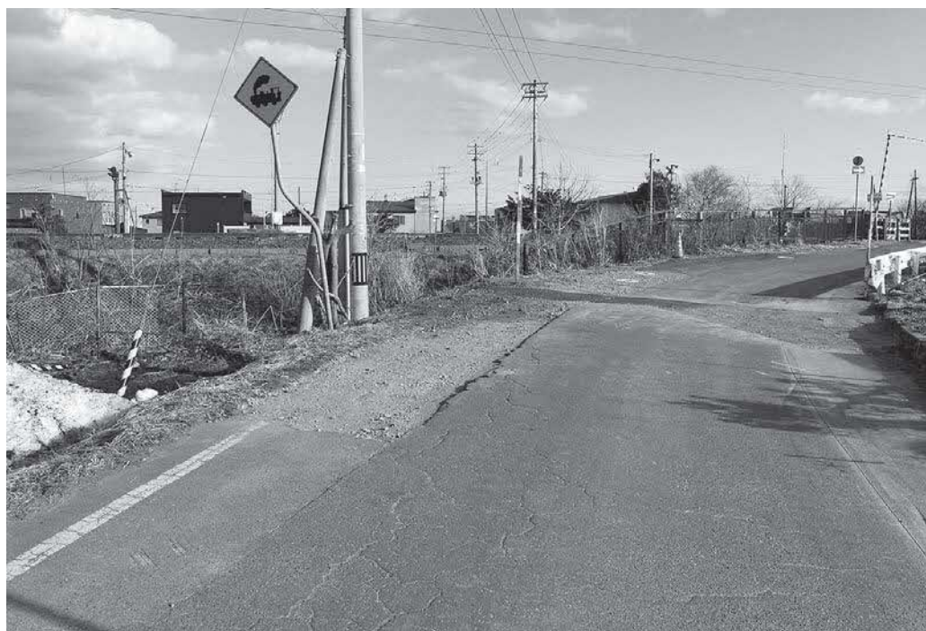
漏水事故が発生した長万部道路踏切付近
