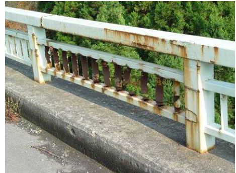
写真1 高欄部材の欠損
