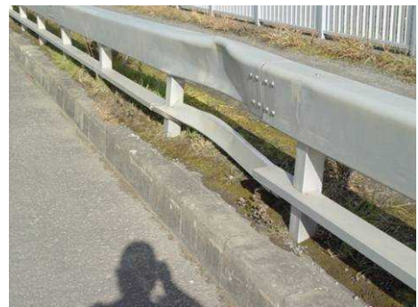
写真2 防護柵の著しい変形
