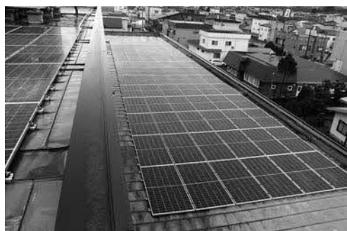
役場庁舎に設置された太陽光パネル
