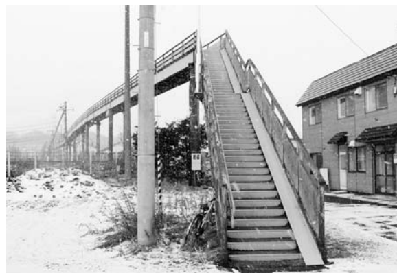
強度不足が指摘された中央跨線橋
