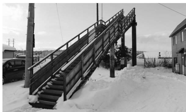
早期改修が待たれる中央跨線橋
