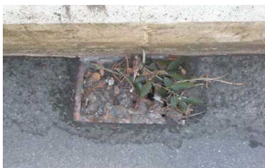
土砂詰り状況
