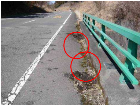
排水桧の土砂詰り（清掃前）
